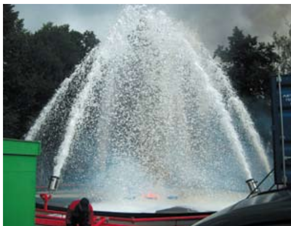
Процесс ликвидации горения на вертолетной площадке с помощью стационарных установок УКТП «Пурга-5»
