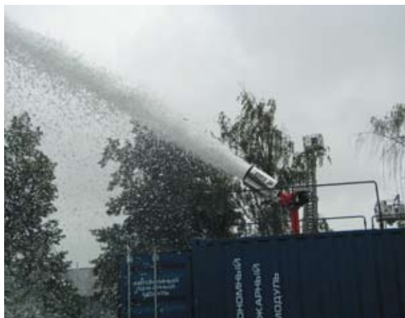
Фрагмент стационарной автоматической системы пожаротушения с УКТП «Пурга-5»
