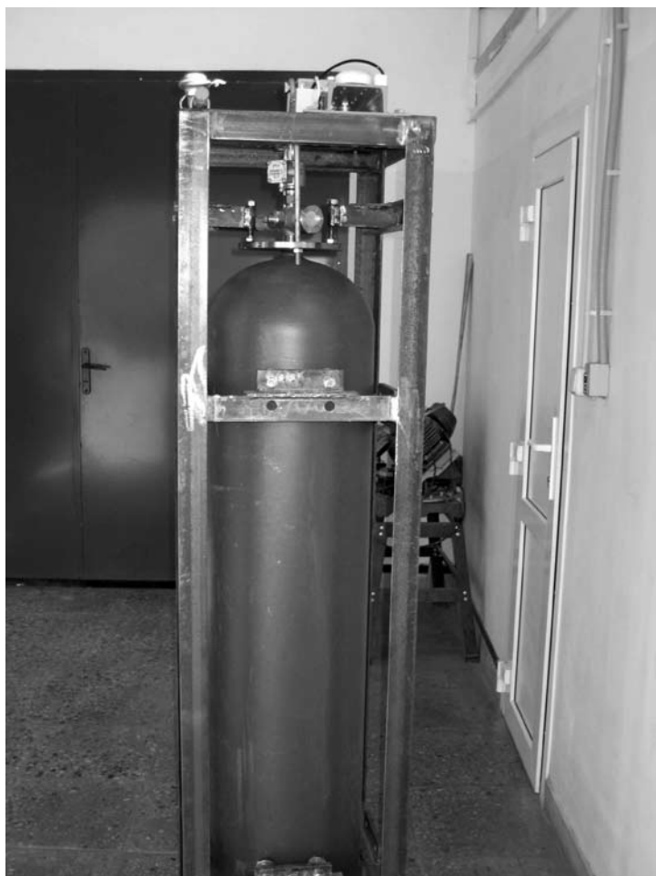
Рис. 2. Стойка с весовым устройством, обеспечивающим сохранность модуля при сейсмических воздействиях
