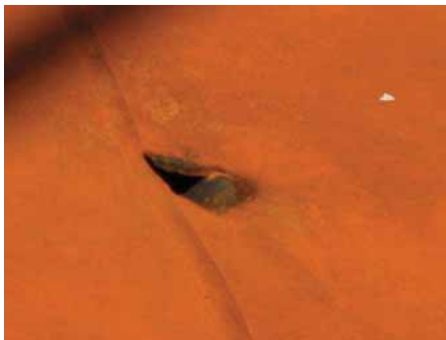
Рис. 6. Характерное сквозное отверстие в крыше РВС № 4
