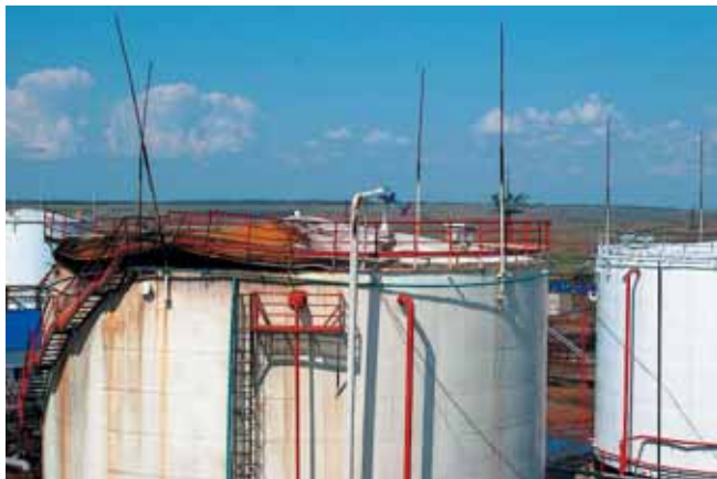
Рис. 9. Характер подрыва крыши РВС № 4
