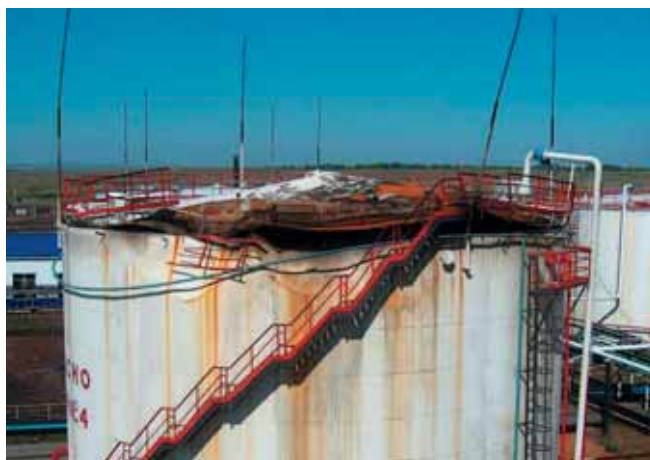
Рис. 4. Характер подрыва крыши РВС № 4
