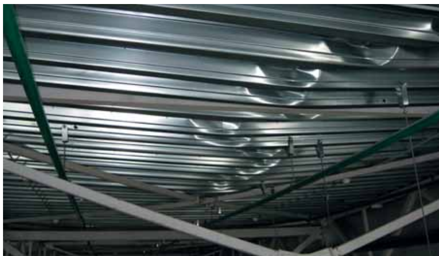
На крыше всю зиму скапливался снег. Очистка его по какой-то причине, возможно, в целях экономии, не производилась, хотя есть эксплуатирующая организация... В результате превышения нагрузки повреждена кровля здания, стоимость ремонта — около 1,7 млн рублей. В выплате по убытку страховщик отказал
