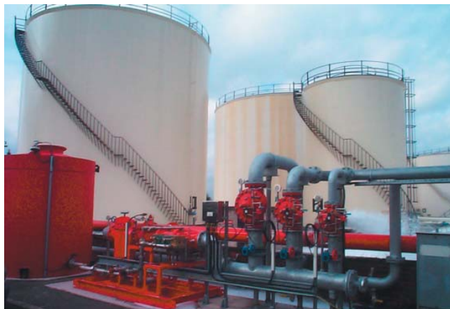
Рис. 3. Применение дозаторов FireDos в системах тушения резервуаров
