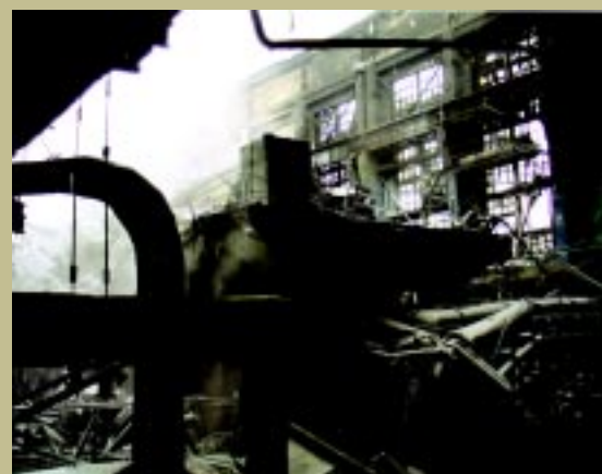
Турбинный цех после пожара (восточная сторона)
