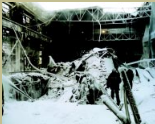
Турбинный цех после пожара (западная сторона)
