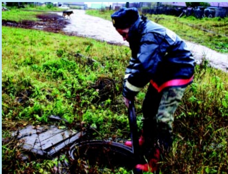
Проверка пожарного гидранта
